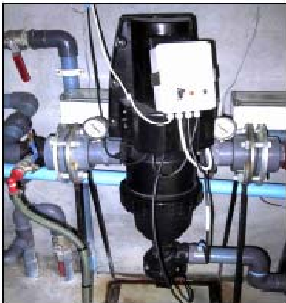
Traitement d'eaux brutes – Station thermale.
