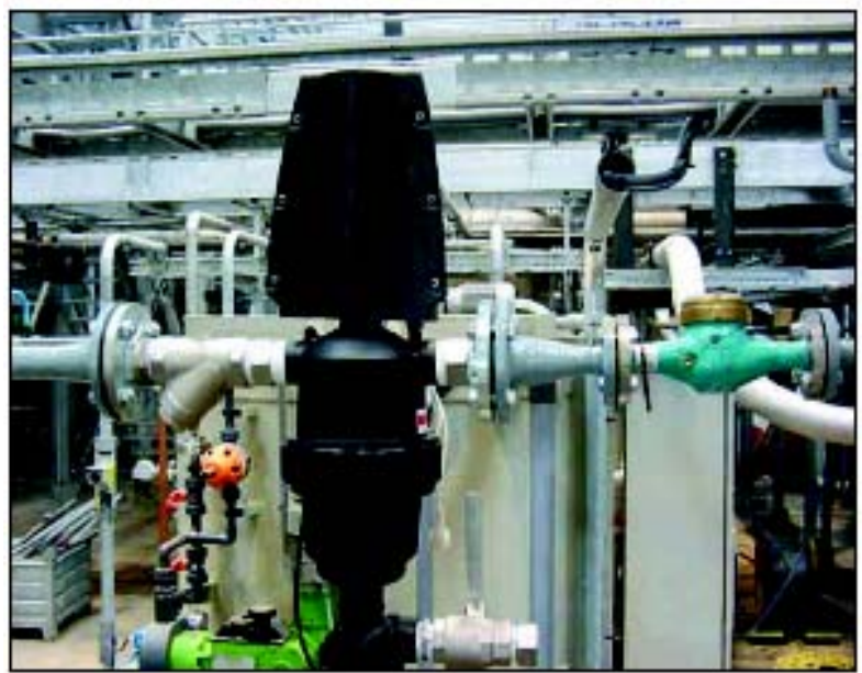
Traitement eaux usées – Centrale thermique.
