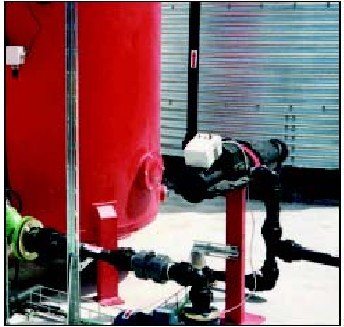
Pré filtration station de traitement d'eau.
